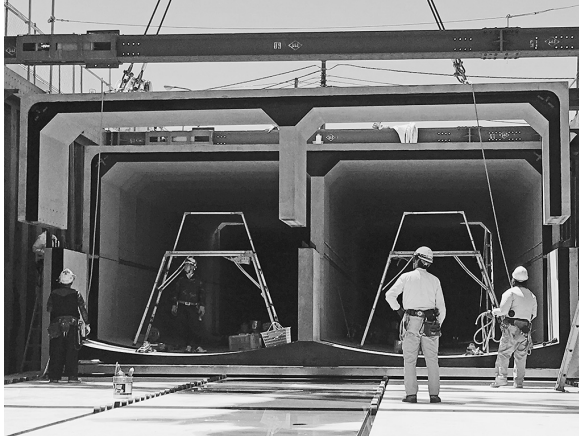
千葉県市川市地方卸売市場に設置した雨水貯留槽
