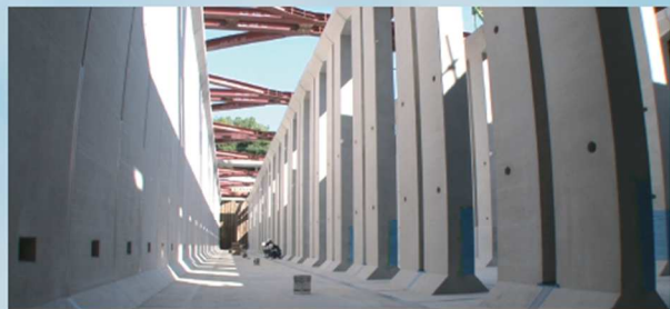
工場で製作した部材を現場で組み立てるプレキャスト化により工期を短縮。ゲリラ豪雨にも対応する特殊バルブを搭載し機能をアップ、進化した「貯留施設」。
