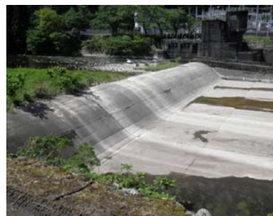
摩耗した固定堰(頭首工)
