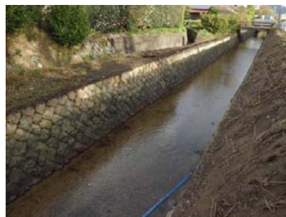
老朽化した石積護岸
