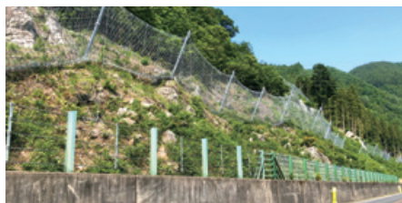
設置状況（近景）
