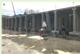
地下式雨水貯留槽
