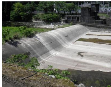
摩耗した固定堰(頭首工)
