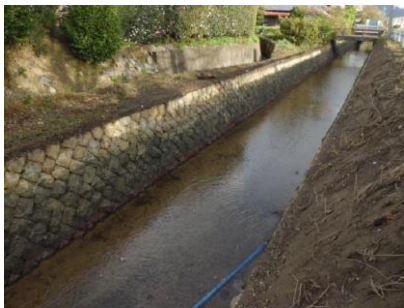
老朽化した石積護岸
