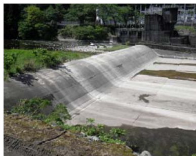
摩耗した固定堰(頭首工)
