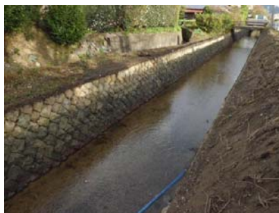
老朽化した石積護岸
