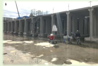
地下式雨水貯留槽
