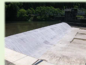
摩耗、洗堀対策用 高強度繊維補強コンクリートパネル メンテナンス事業
